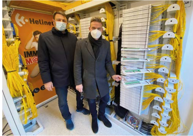
André Dreifsen (links) und Andreas Sunder besichtigten den Glasfaser-Hauptverteiler in Neuenkirchen.
