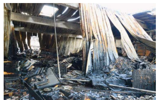
Der Tag danach offenbart das Ausmaß der Zerstörung. Die Lagerhalle ist komplett niedergebrannt.
