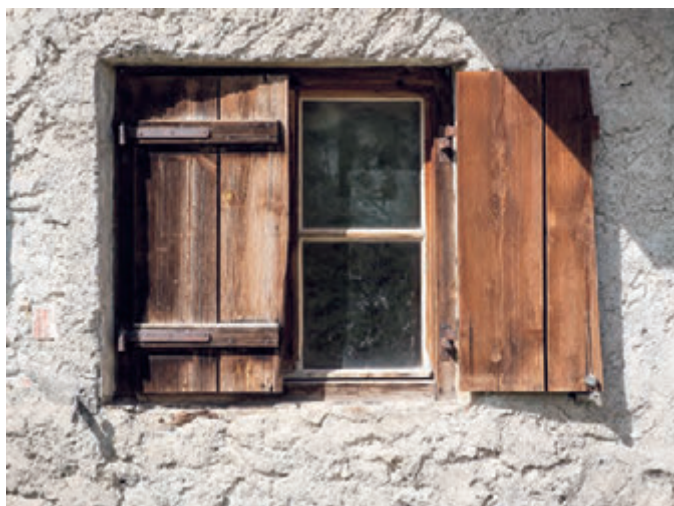
Wenig energieeffizient: Durch alte Fenster gelangt kalte Luft von draußen in den Raum. Foto: pixabay
