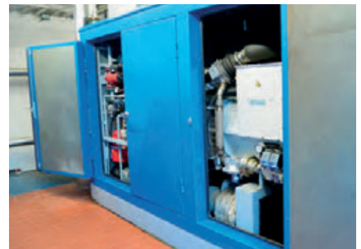
Etwa 60 Prozent des Strombedarfs erzeugt die Kläranlage selbst und deckt ihren Wärmebedarf komplett.
