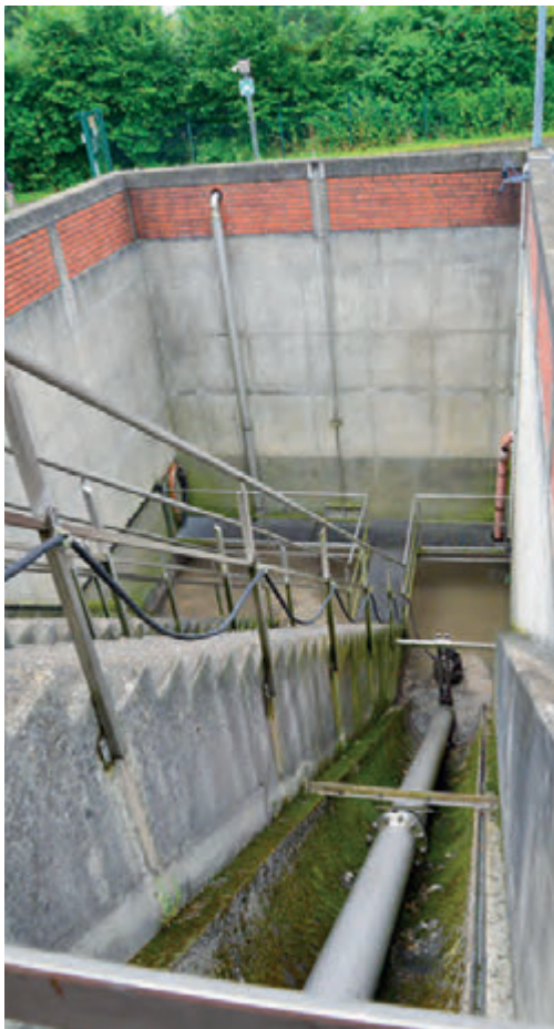
Erste Station: Hier kommt das Schmutzwasser bei dem Klärwerk an.
