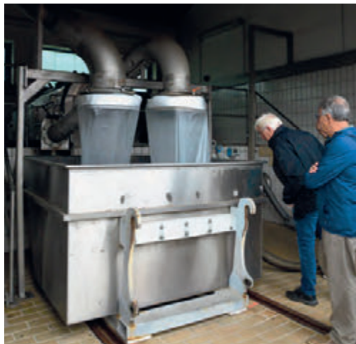
Herausgefilterte Gegenstände werden in großen Auffangbehältern gesammelt.
