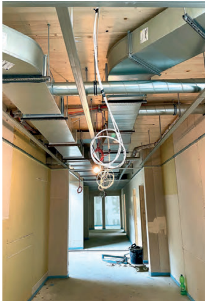
Alle Neubauten, die die Stadt Rietberg errichtet, werden direkt mit modernen Lüftungsanlagen ausgestattet. So auch im Kindergarten in Druffel. Foto: Stadt Rietberg
