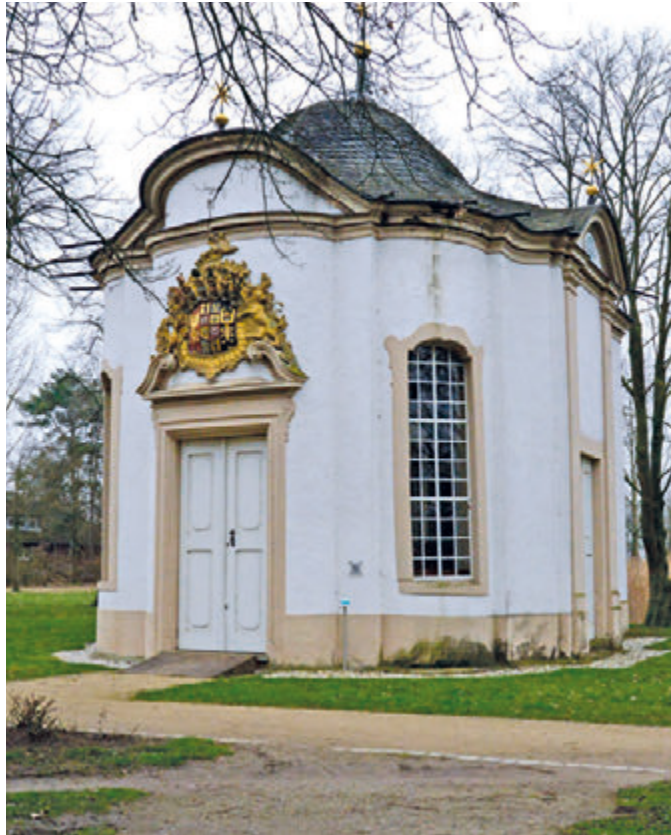
Die Johanneskapelle muss dringend saniert werden. Fördergelder wurden für dieses Jahr jedoch abgelehnt. Foto: RSA/Addicks
