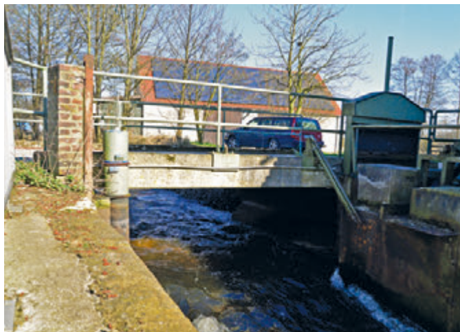
Die Stauanlage an Antfängers Mühle dient nicht nur dem Hochwasserschutz, sondern auch der Stromgewinnung.
