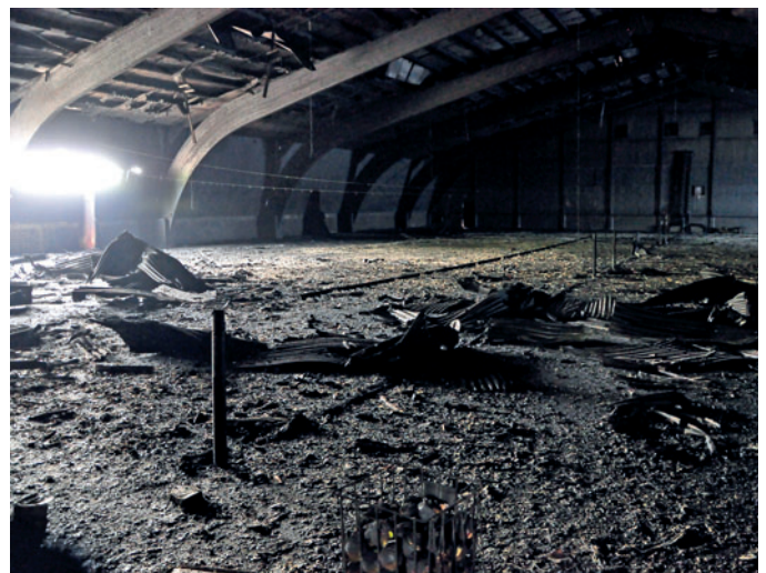
Blick in die Tennishalle der Brüder Rainer und Werner Löher zeigt die totale Verwüstung. Neuerrichtung der Anlage ist geplant zum Saisonbeginn September 2021.
